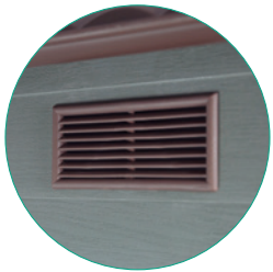
DOBLE REJILLA DE VENTILACIÓN DOUBLE VENTILATION GRILL
